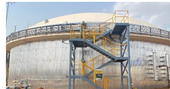
ATGL (Barsana Biogas Plant)
